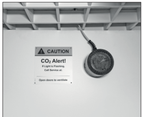
ไฟสัญญาณเตือนพร้อมป้ายคำเตือน
