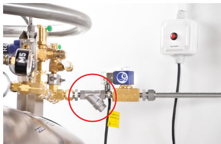
SMB et la vanne d'arrêt équipée d'un filtre
