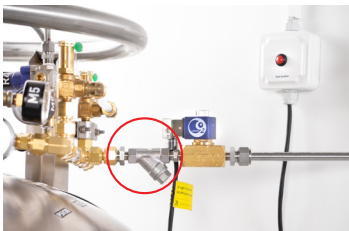
SMB y válvula de cierre instalada con filtro
